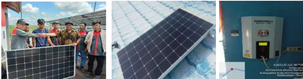
Gambar 1 Penyerahan Panel Surya ke Pengurus Desa (a), Pemasangan Solar Panel 260 Wp di atas atap rumah Ibadah (b), Foto Pemasangan Powerwall di dalam rumah ibadah (c)
