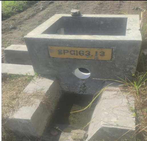
Gambar 9. Outler sumur pompa air tanah
