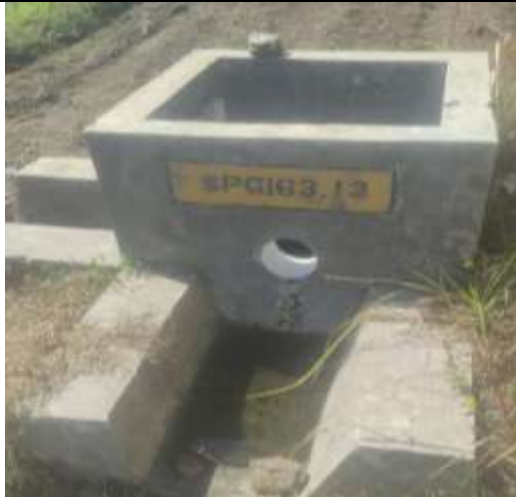
Gambar 9. Outler sumur pompa air tanah
